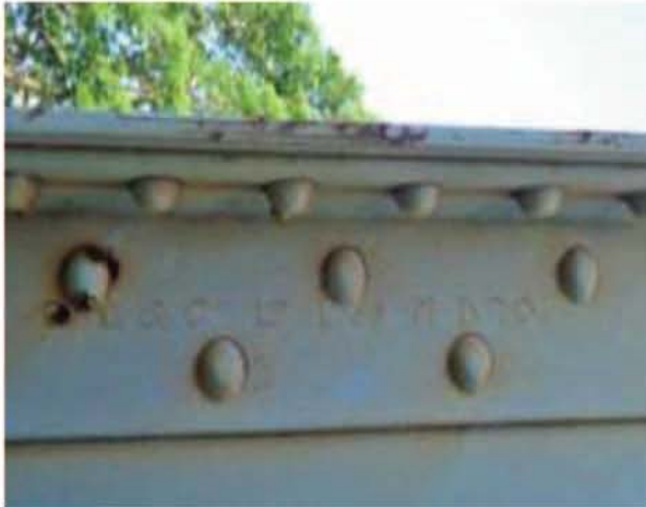
รูปที่ 4.46 หมุดย้ำ ในการเชื่อมต่อ โครงสร้าง ต้องอัดแน่นและทำให้แผ่นเหล็กแนบ ติดกันสนิทมีใช้น้อยมากในยุคนี
