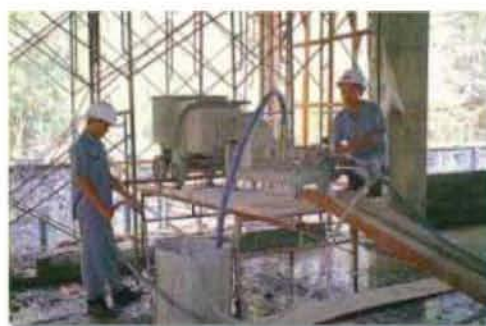
รูปที่ 4.128 Grouting ด้วยน้ำปูนระบบ Bonded System เข้าไปในท่อร้อยสลิง
