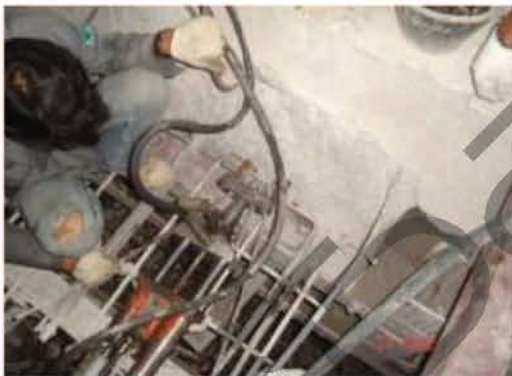
รูปที่ 4.126 เมื่อคอนกรีตมีความแข็งแรงตามที่กำหนดแล้วจะต้องทำการดึงและยึดสลิงไว้กับหัว Anchorages
