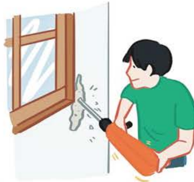
ไม้จริง ติดตั้งระบบเปียก จะรั้อต้องสกัดผนังปูน
