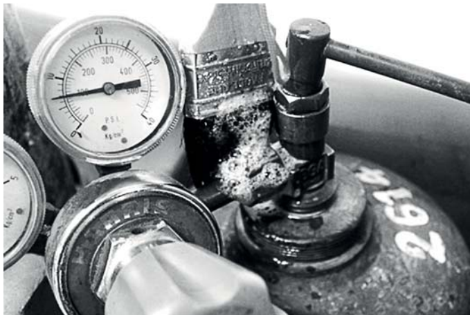
รูปที่ 1.4 แสดงการตรวจสอบรอยรั่วของแก๊สตามจุดต่อ
