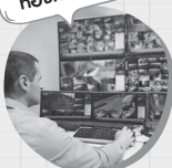
Unit 14 ห้องควบคุม
