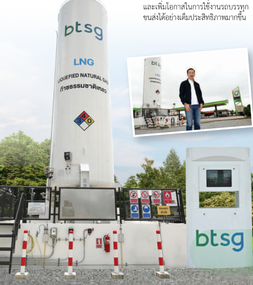
สถานีบริการก๊าซธรรมชาติเหลว แห่งแรกในประเทศไทย (ใบอนุญาตลำดับที่ 1 จากกรมธุรกิจพลังงาน) ณ สถานีบริการบางจาก สาขาบางเขย กม.15 อำเภอสรรพยา จังหวัดชลบุรี
