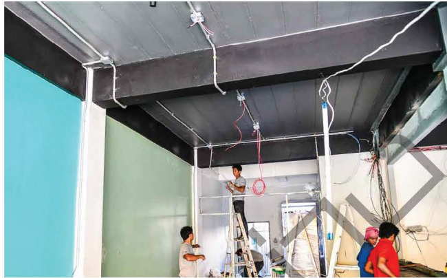
รูปที่ 1.11 งานระบบไฟฟ้า (ที่มา : https://www.prosecurenet.com )
