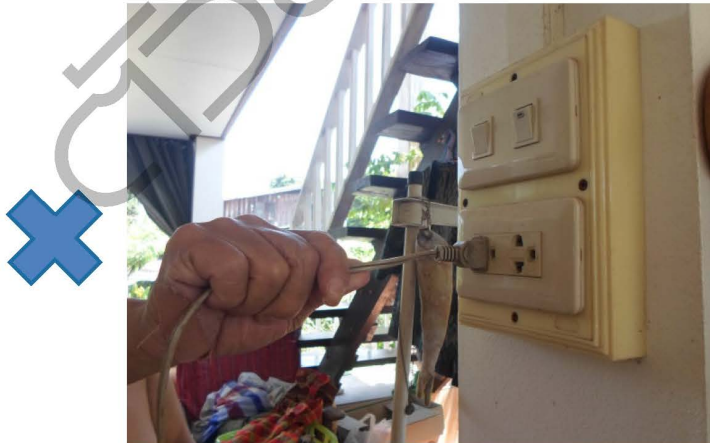
รูปที่ 1.5 การถอดเต้าเสียบที่ไม่ถูกต้อง โดยดึงที่สายไฟ
