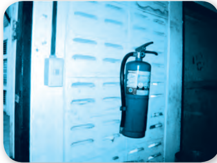
รูปที่ 1.6 แสดงบริเวณติดตั้งเครื่องดับเพลิง
