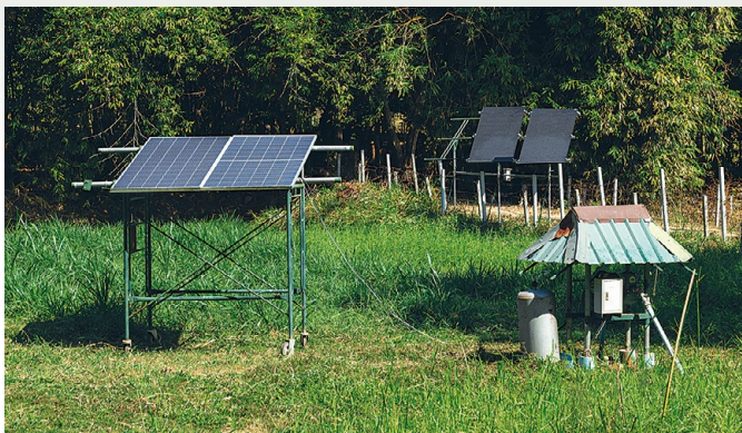
ต่อปั๊มชักสำหรับสูบน้ำในฟาร์มกับแผงโซลาร์เซลล์ โดยติดตั้งกับนั่งร้านเพื่อให้สามารถเคลื่อนย้ายไปรับแสงแดดได้ตลอดปี เมื่อคำนวณต้นทุนแล้วคุ้มมาก
